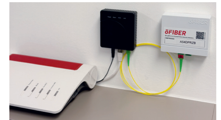
Abb.: Beispiel einer Installation.
